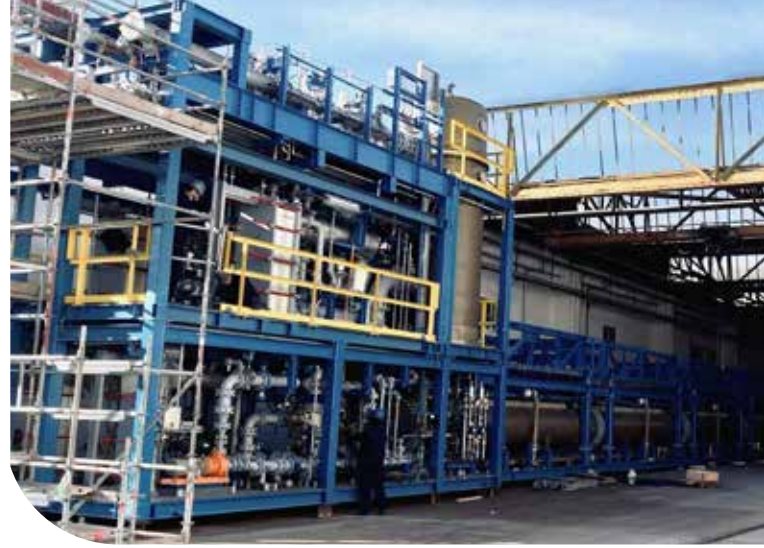
©thyssenkrupp Uhde Chlorine Engineers GmbH
